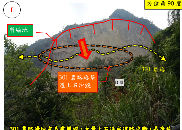
301 農路邊坡有多處崩塌，大量土石造成道路中斷，長度約 230 公尺。
