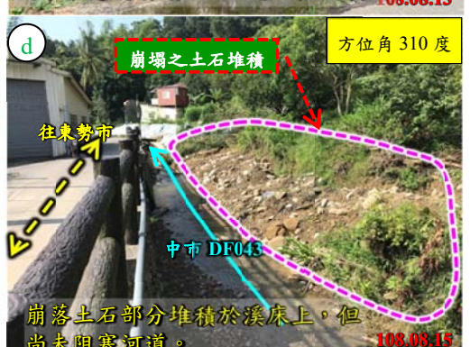
崩落區下方目前正由台中分局施作野溪整治工程。 108.08.15
