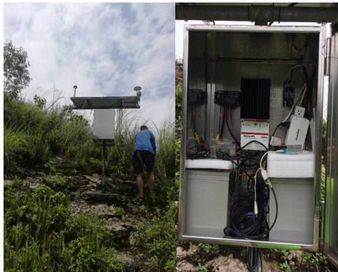
GNSS監測站設施配備
