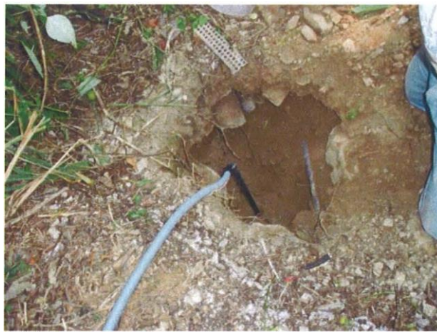
圖 7 土壤含水量計安裝示意
