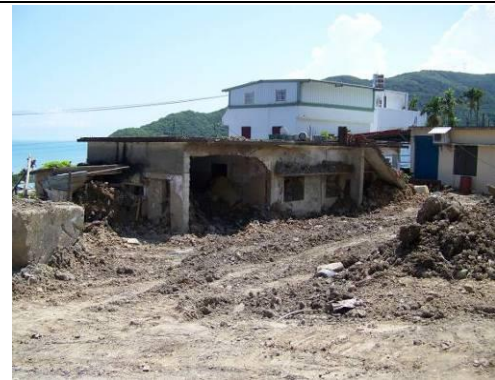
撞擊：土石撞擊構造物 【98 年莫拉克颱風臺東縣大武鄉土石流災害】
