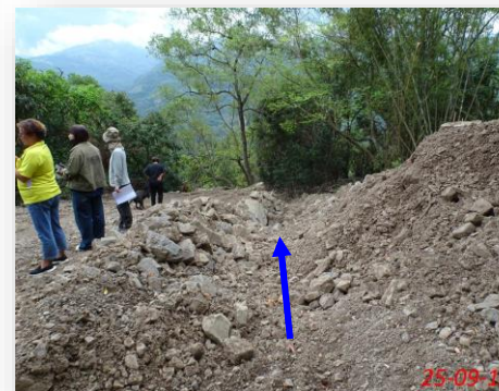
(5)原設有護岸排水渠 道，0728豪雨期間已 遭土石淤埋。
