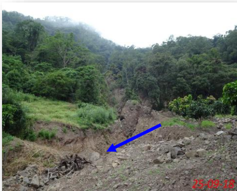
(1)上游新生崩塌現況， 為0728豪雨所造成。
